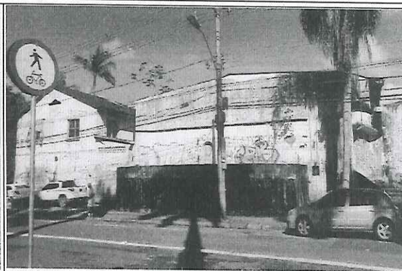
VISTA FRONTAL - EDIFICAÇÃO EM RUÍNAS
