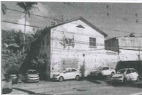
VISTA EDIFICAÇÃO EM RUÍNAS
